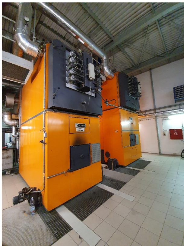
Foto: Kotle na biomasu v centrální výtopně, vlevo kotel UTSR 1600, vpravo UTSR 2400
