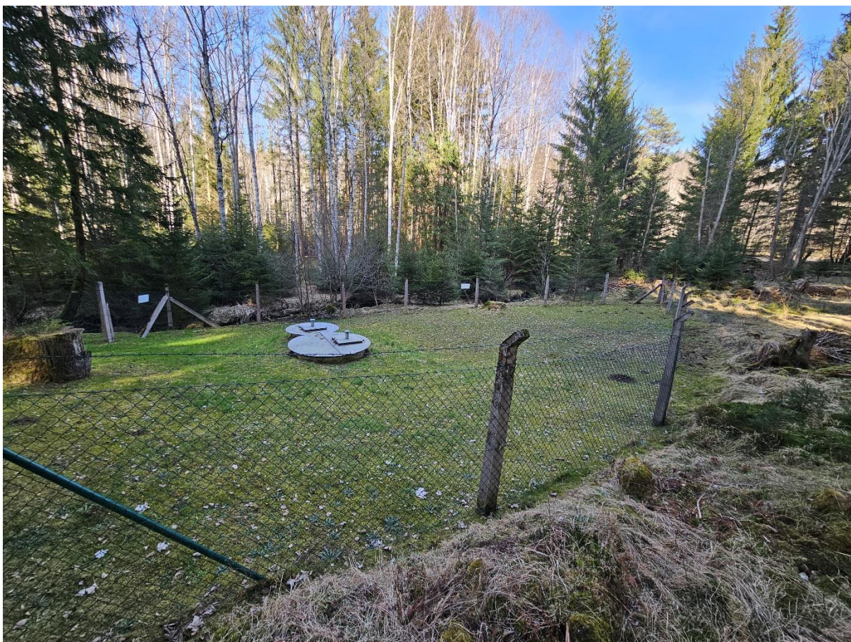
Obr. č. 8. Prameniště a jímací jímka nad obcí Červená
